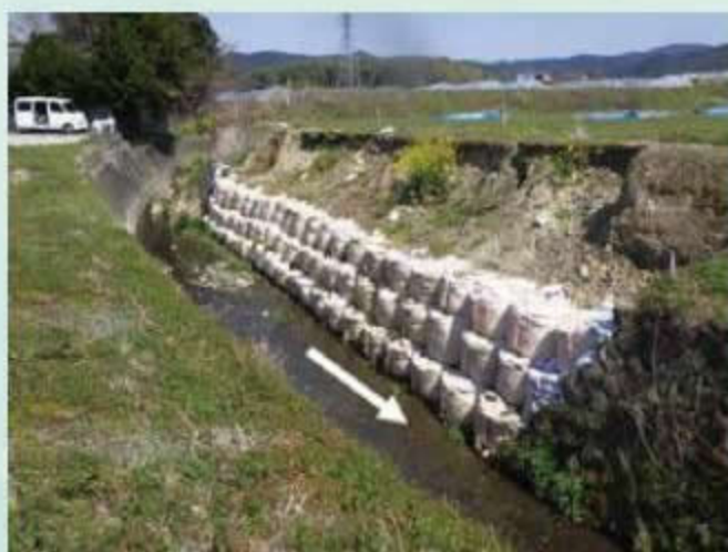
上津荒木川(久留米市)被災状況
