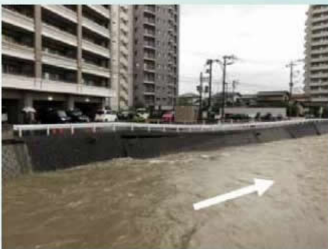
やまぐち 山口川(筑紫野市)被災状況
