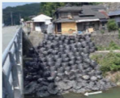
高崎川（大牟田市）被災状況
