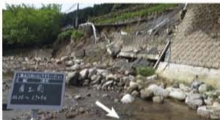
大肥川(朝倉市)被災状況
