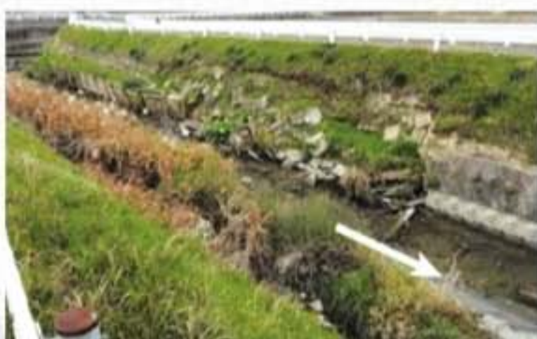
湊川(田川市)被災状況
