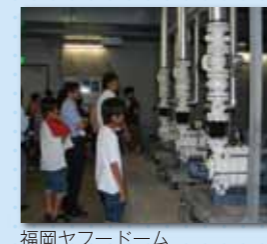
福岡ヤフードーム 雨水利用施設
